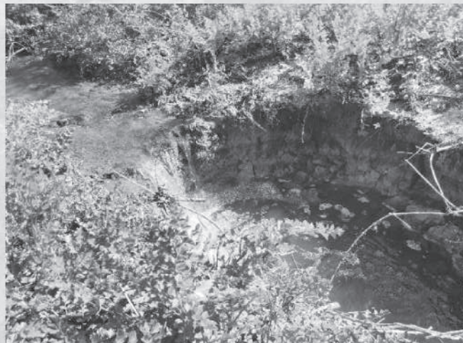
Erosion en cours de la parcelle (mars 2026).
